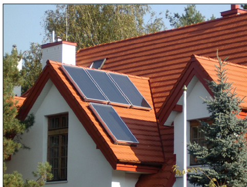
Fot.1. Płaskie cieczowe kolektory słoneczne zamontowane na połaci dachowej
