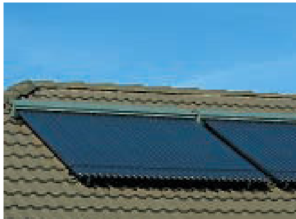
Fot.2. Kolektory próżniowe na połaci dachowej
