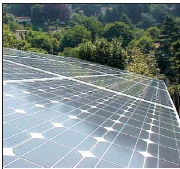
Fot 9. Moduły PV zainstalowane na połaci dachowej
