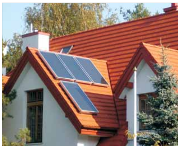
Fot.1. Płaskie cieczowe kolektory słoneczne zamontowane na polaci dachowej
